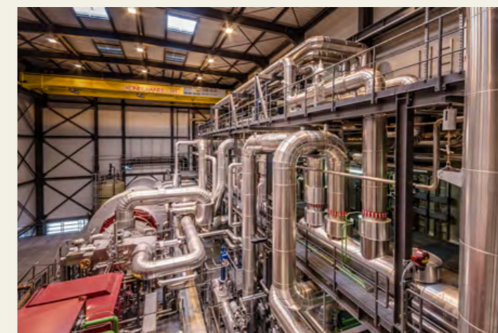
Neues Maschinenhaus mit Turbine 4 und allen notwendigen Komponenten für den neu installierten Wasser-Dampf-Kreislauf, inkl. Fernwärmeproduktion.
