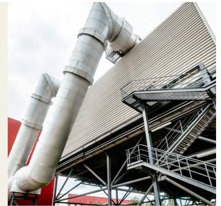
Abdampfleitungen zu Luko 4.
