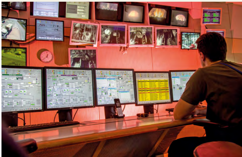
Die Leitwarte im MHKW.
